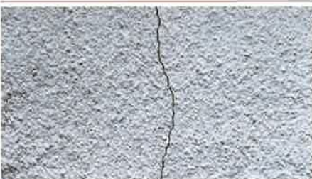
■ひび割れ発生
