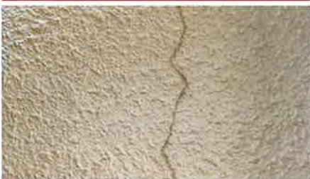
■ ひび割れ発生
