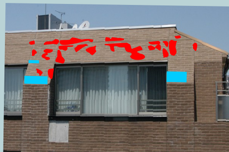
タイル浮き、滞水箇所の検出
